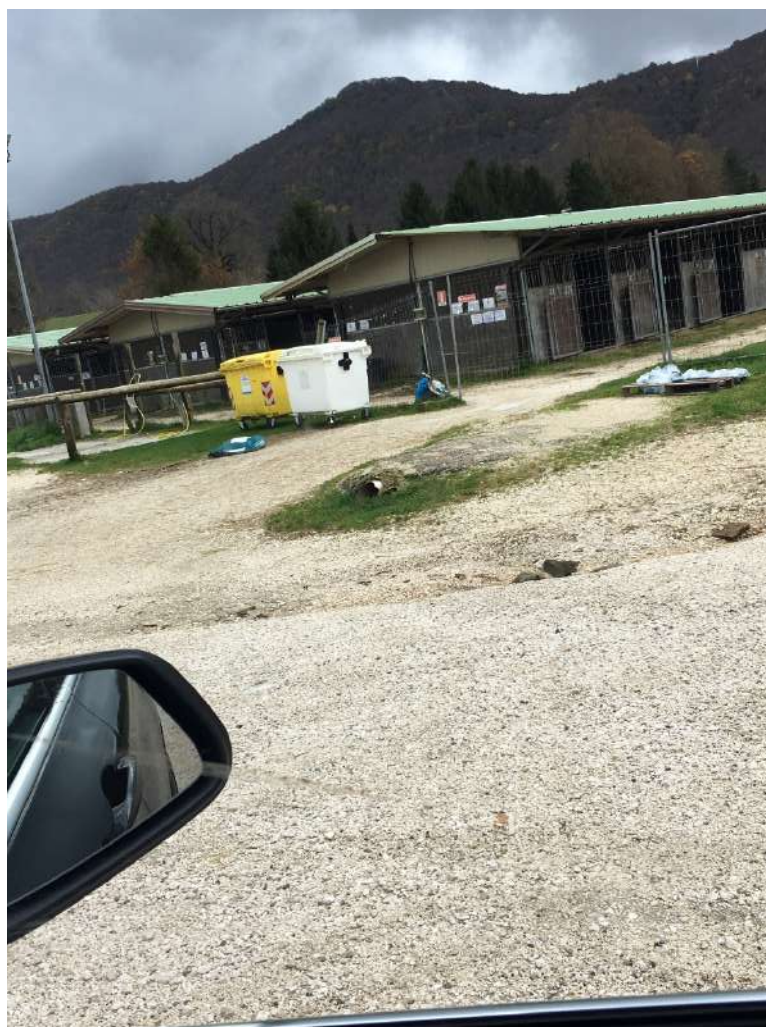
Foto 7_Particolare stato di degrado di una delle strade di accesso al maneggio
