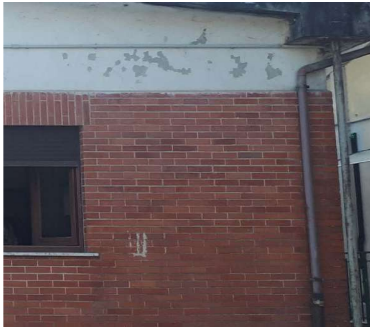
Foto 3_Particolare stato di degrado facciata frontale edificio Uffici
