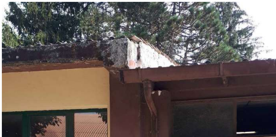
Foto 1_Particolare stato di degrado cornicione Foresteria
