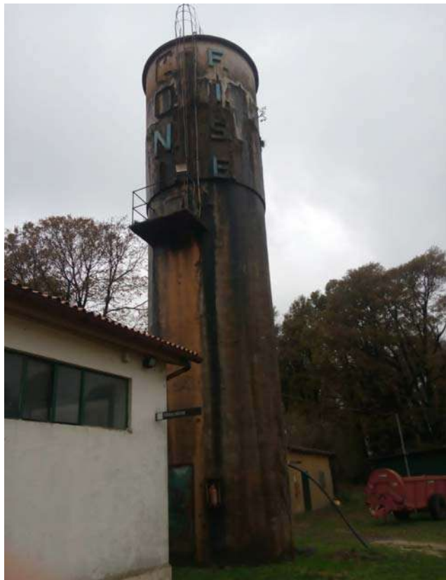
Figura 6_ Torre Piezometrica - degrado
