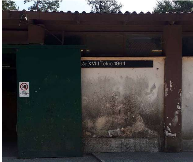
Foto 2_Particolare stato di degrado Scuderie "Tokyo"
