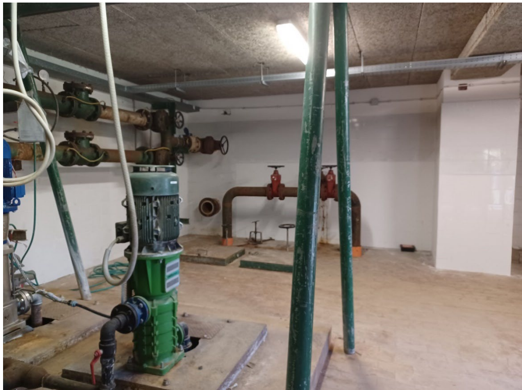
Cono di visuale I – Impianto di sollevamento nel centro idrico “Frascati” presso Rocca di Papa (RM)
