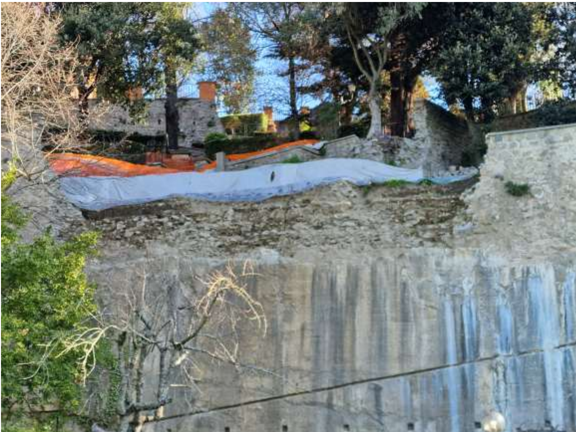
Foto 2: Veduta di dettaglio delle porzioni di muro di confine crollate, con gli interventi di messa in sicurezza realizzati per eliminare il rischio di ulteriori crolli e/o caduta frammenti.
