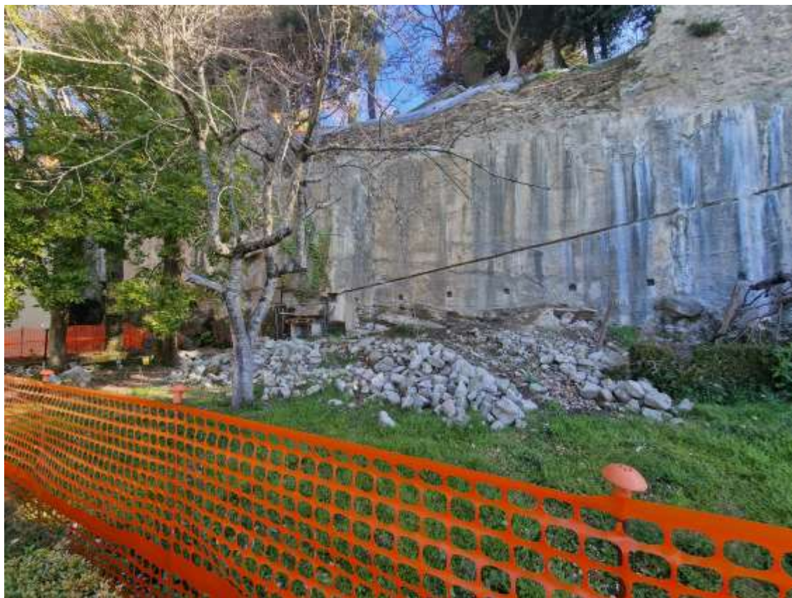
Foto 3: Vista che inquadra le macerie nella part. 32 di proprietà del Collegio di San Tommaso degli Inglesi, nell'area immediatamente al di sotto delle parti di muro crollate
