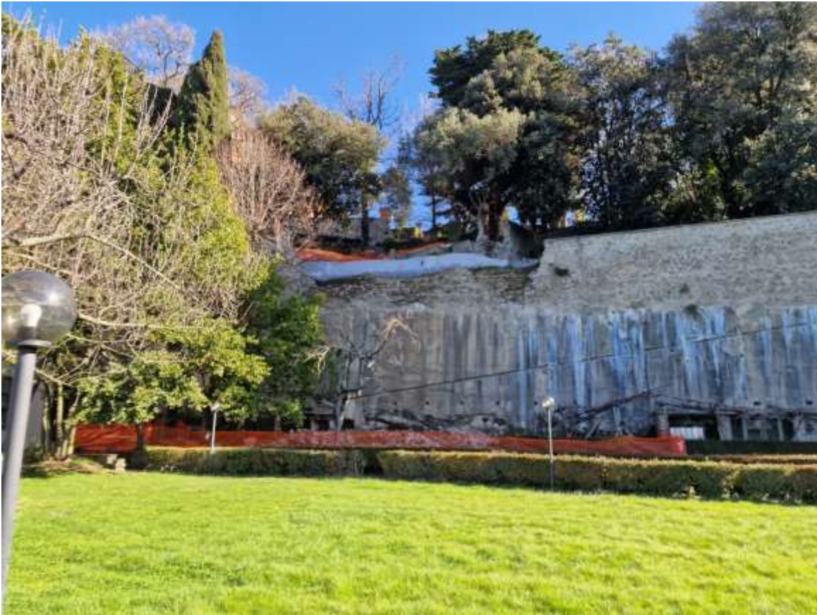
Foto 1: Veduta dalla part. 32 sul muro di confine oggetto di crollo, in seguito ad evento meteorologico avverso e alla conseguente messa in sicurezza di tutta l'area.
