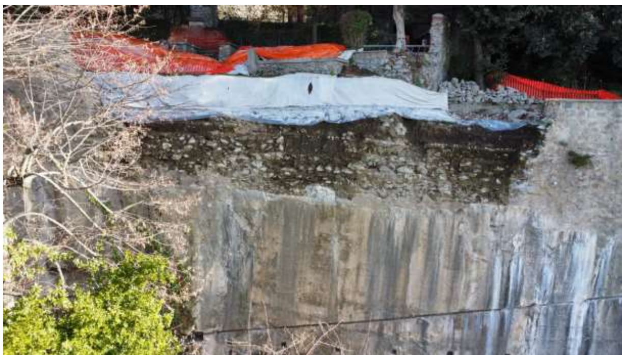
Foto 11: Veduta frontale sulla grande lacuna muraria, con dimensioni totali di circa 15 m di lunghezza per almeno 4 m di altezza (non considerando il muro fuori terra). Al di sotto, il banco di peperino con macchie dovute al dilavamento.
