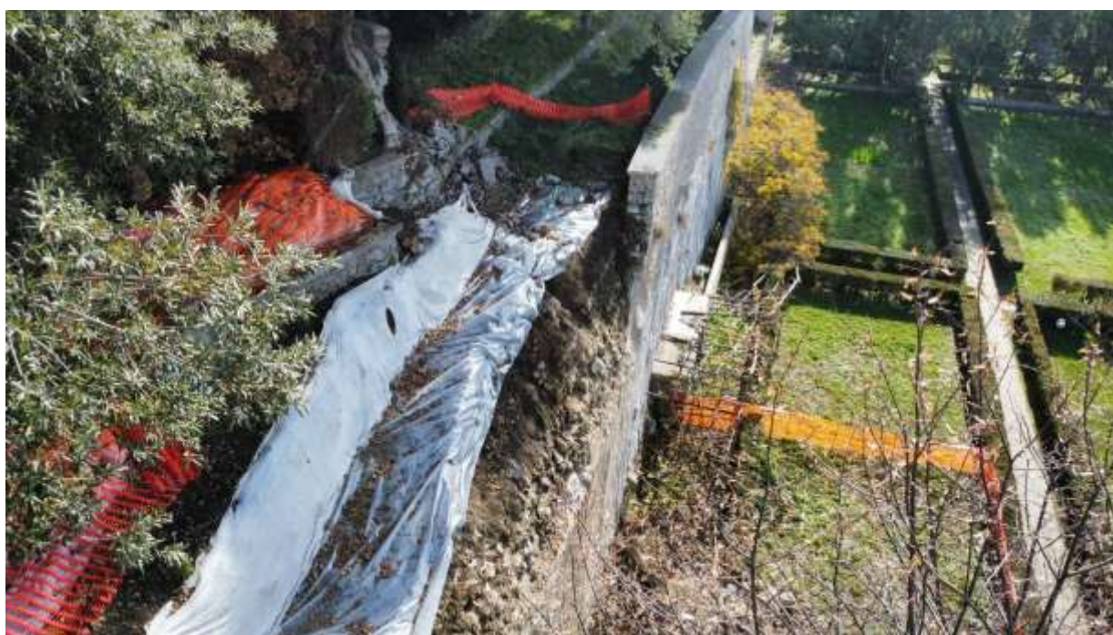
Foto 12: Vista dall'alto dell'area interessata dal crollo e dalla successiva messa in sicurezza
