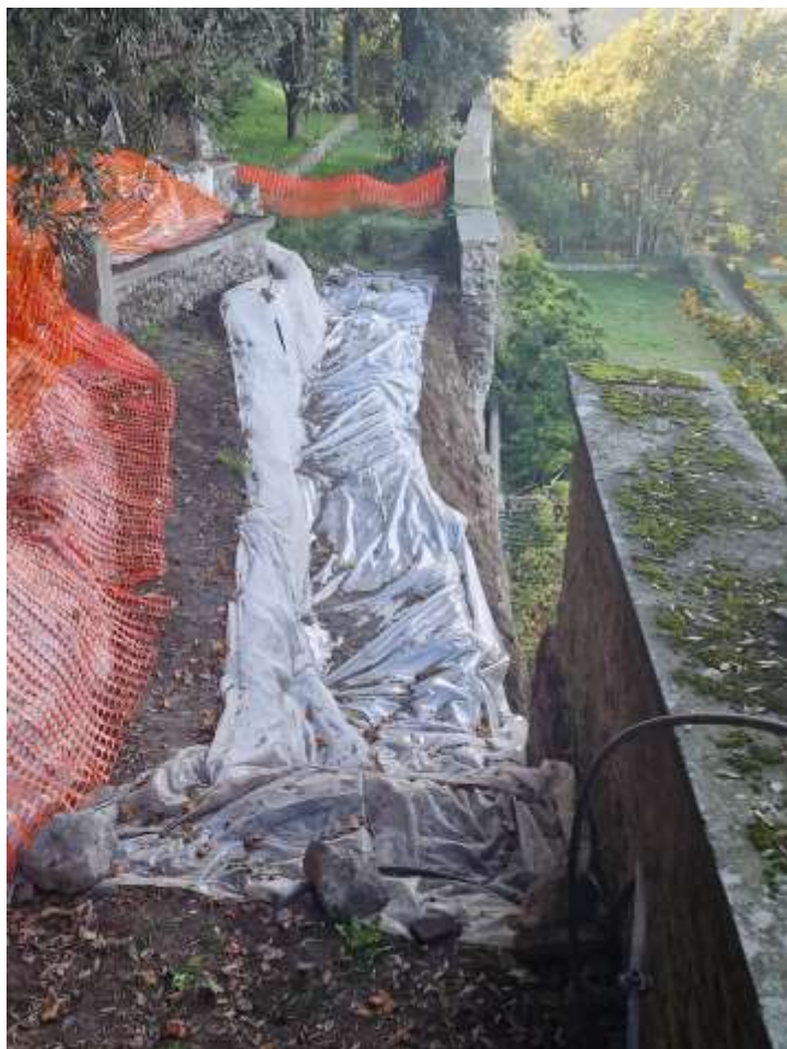
Foto 9: Visuale complessiva sull'area oggetto di crollo delle porzioni di muro di confine.
