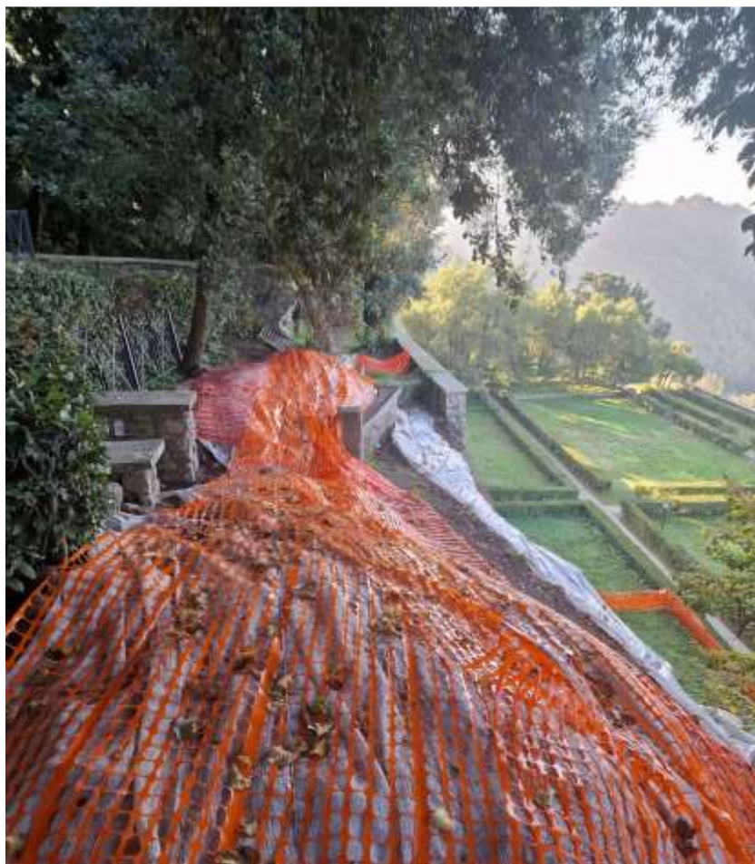
Foto 7: Altra veduta sull'area interessata dal crollo dei tratti di muro di confine.
