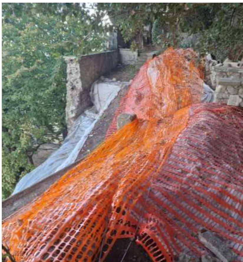
Foto 8: Inquadratura che mette in evidenza il muro longitudinale strappato tra la part. 27 e la 32, e il terreno messo in sicurezza.
