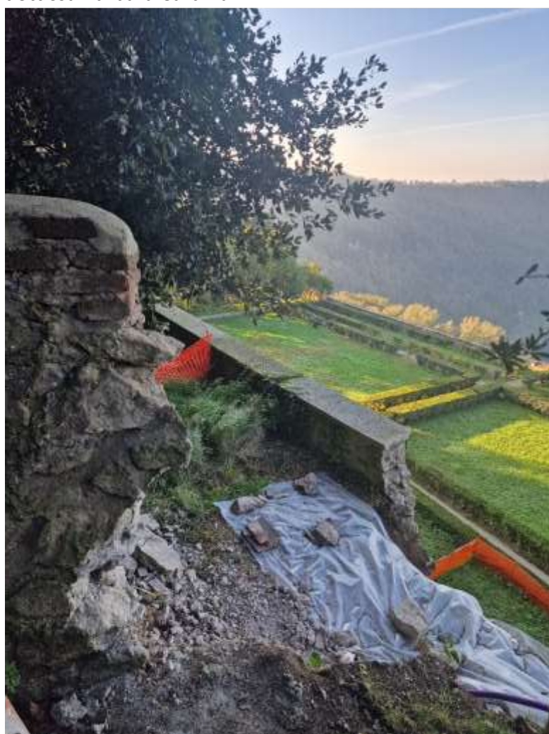
Foto 6: Vista di dettaglio sullo strappo del muro trasversale, tra la part. 27 e la part. 36.
